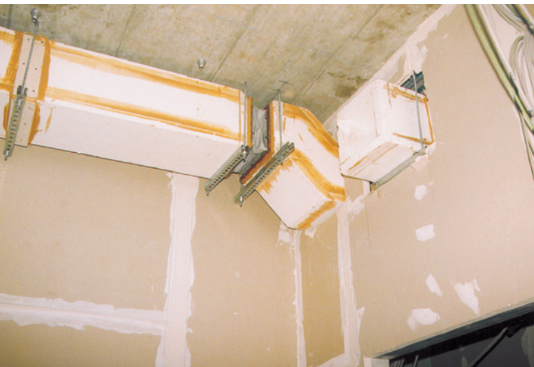
Körperschall-Entkopplungselement (Segeltuchstützen) in einem Entrauchungsschacht
