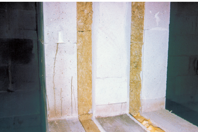
Fensterausschnitt zweier massiver Raum-in-Raum-Konstruktionen, links und rechts neben einer Trennwand
